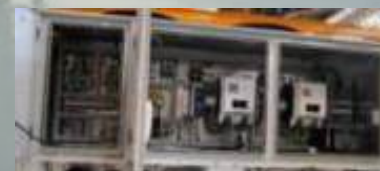
Quadro de força e controlo separados
